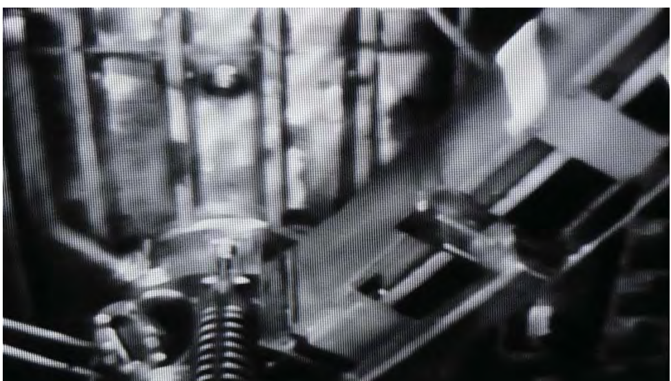
図2. ブスバー結合装置接続部（平成29年7月26日撮影）
